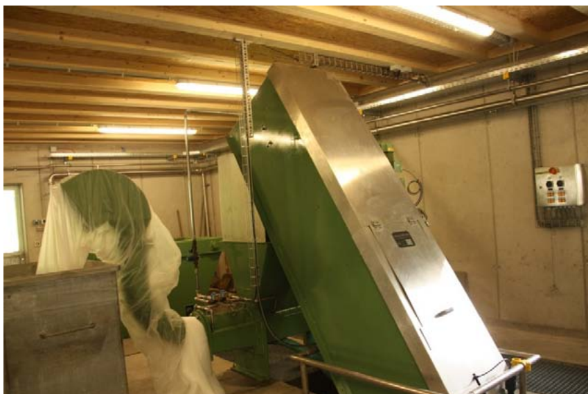
Rechen der mechanischen Vorreinigung in Parzutt
