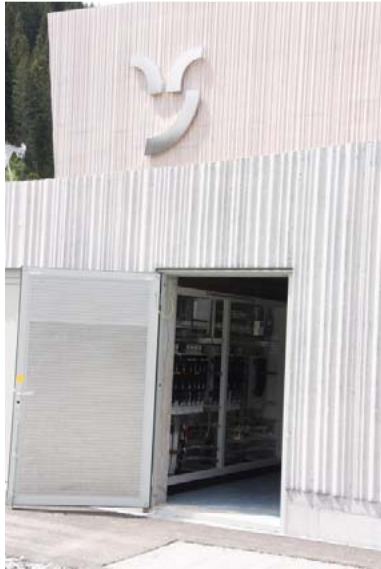
Trafostation im Gebäude Portal
